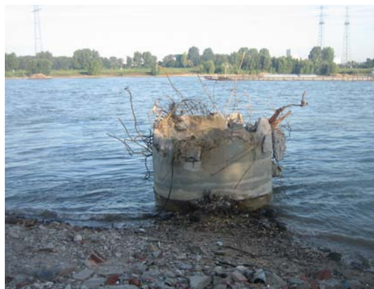
Bild 8: Tiefbrunnen mit Wasserlinie abgebrochen
